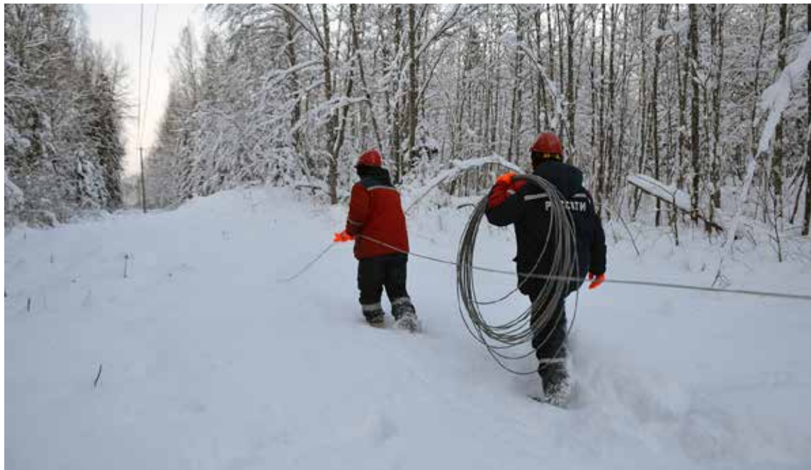
По территории Северо-Запада в декабре прошло несколько циклонов с ледяными дождями и снегопадами, что вызвало перебои в подаче электроэнергии
